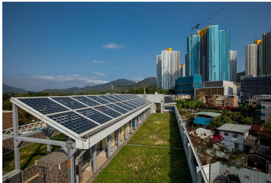
香港皇后山變電站的屋頂太陽能板
